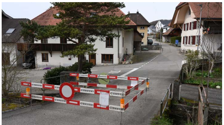
Die gesperrte Brücke «Oberdorfstrasse»: Ersatz oder Abbruch?
